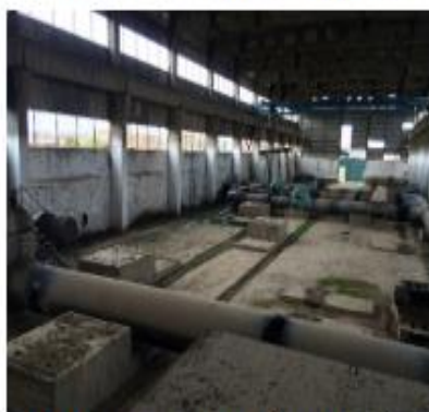
Насосная станция (изнутри)
